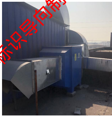
活性炭装置+排气筒1#
