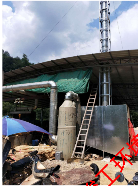
水膜除尘器+布袋除尘器+15米 排气筒
