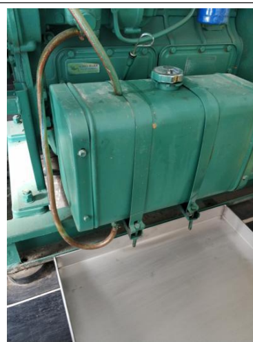
发电机房防渗托盘
